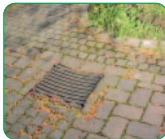
Keine Abschwemmung von Pflanzenschutzmitteln in die Kanalisation
