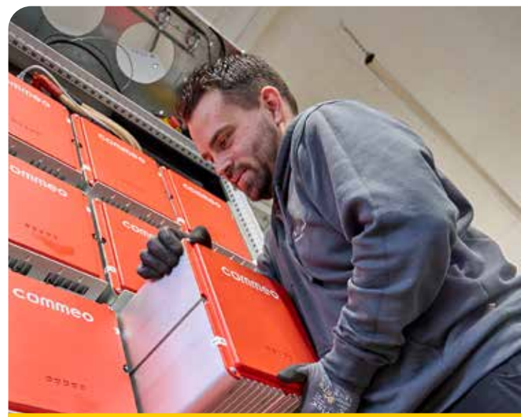
Der letzte Akku wird eingesetzt und macht damit den großen Speicher komplett.
